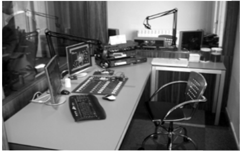
Instal·lacions de Ràdio Vilablareix.
